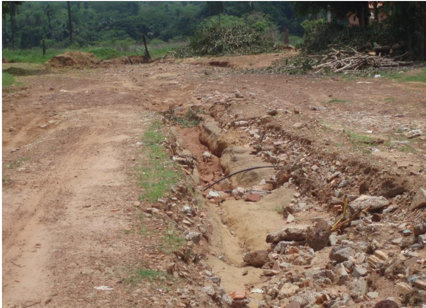
Foto IV - Erosão laminar em Canabrava do Norte
